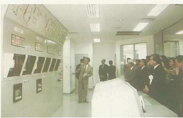
センター内オペレーター室
