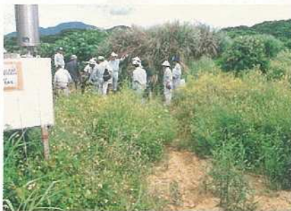
土砂で埋まった沈砂池
