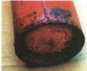
層状はく離の腐食
