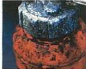
あばた状の腐食
