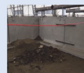
前処理後 掘起こしごみヤード
