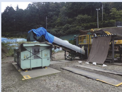
搬送コンベヤ及び 脱着式コンテナ(灰土砂類)
