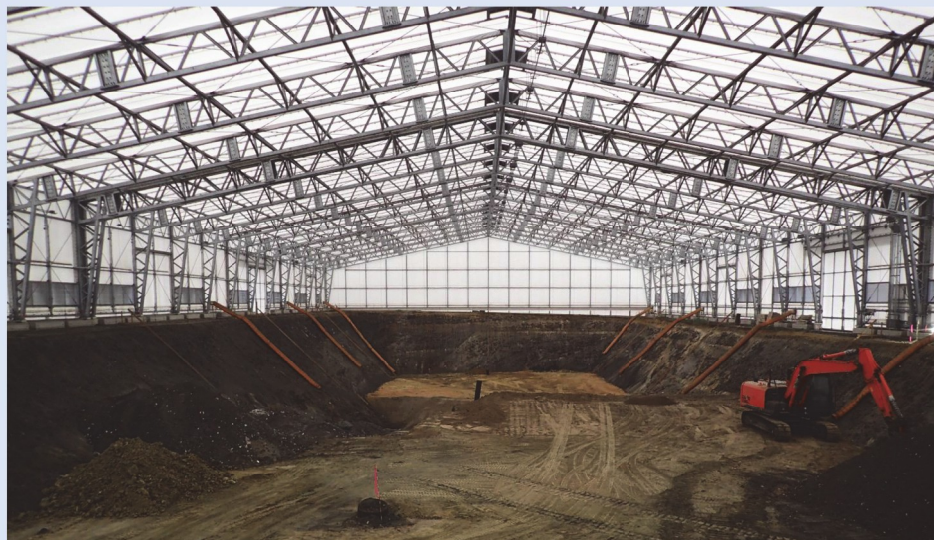
〔覆蓋設備内観写真〕
