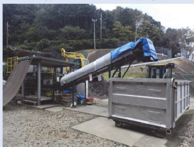
搬送コンベヤ及び 脱着式コンテナ(可燃物)
