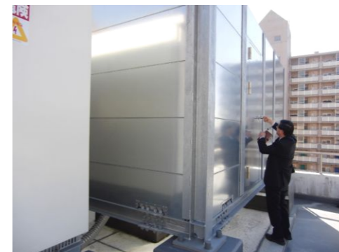
非常用発電機外枠
