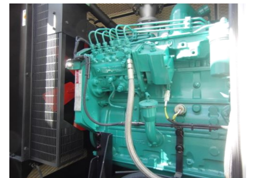
非常用発電機
