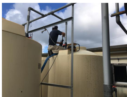
図 2-7-5：ポンプを付けたホースを貯留槽に入れて液肥を送り出す
