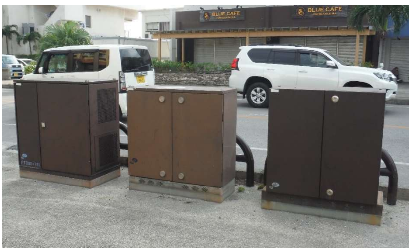
地上機器設置例(石垣市内)
