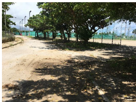
多目的広場から園路への土砂流出
