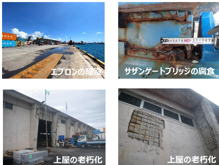
石垣港の施設の老朽化の状況
