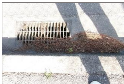
⑤落葉による排水施設の詰まり
