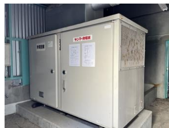
非常用発電機
