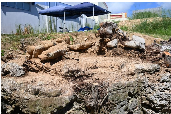
爆弾を受けめくれ上がった鉄筋と吹き飛んだセメント袋
