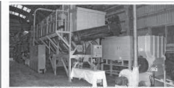
完成した廃プラ処理プラントの一部
